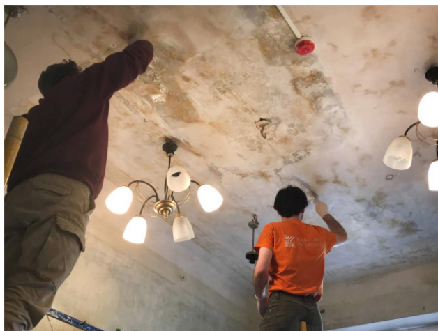
Рис. 5. Замокання стелі у процесі побуту
